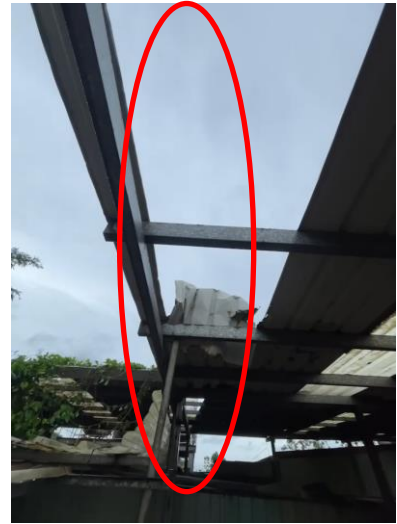
犬舍屋頂鐵皮整區遭吹走
