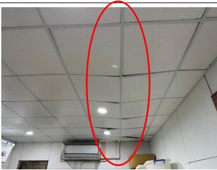
保育場主結構遭強風吹動、搖晃擠壓，致醫務室輕鋼架變形
