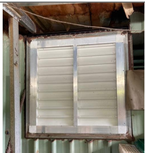
增設百葉窗調節負壓風扇使用
