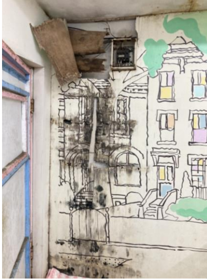
電箱上方屋頂漏水導致牆面腐爛、跳電
