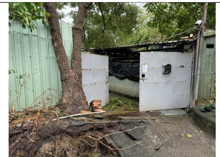
大門遭樹壓歪，難以完全緊閉犬區大門
